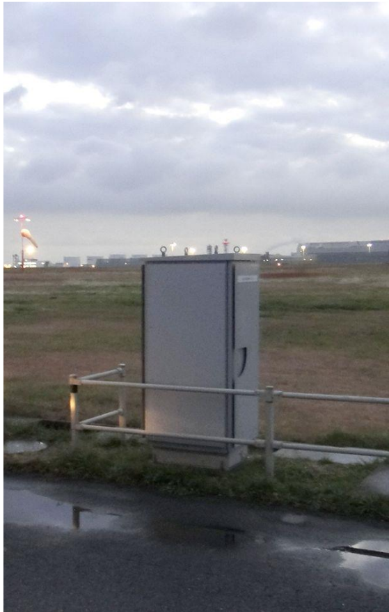
管理区に設置された収納架
