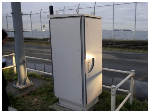
滑走路傍に設置された収納架
